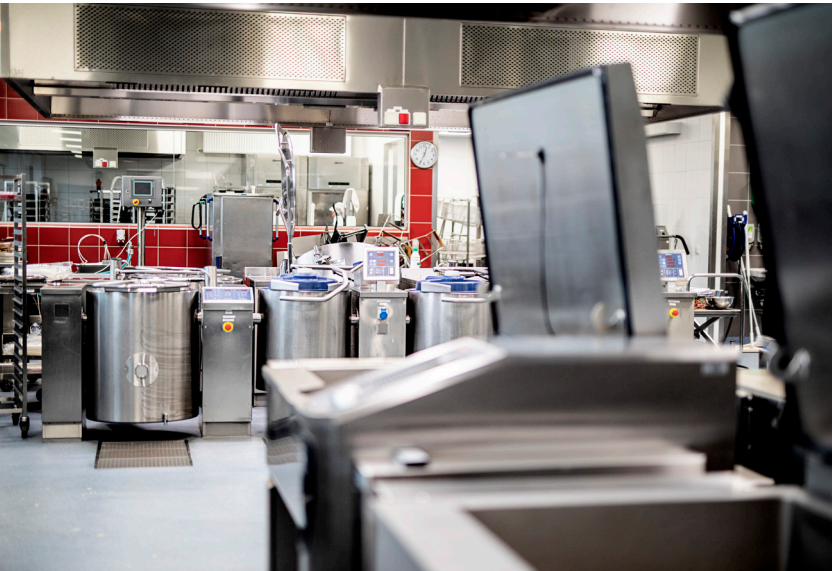
AARHUS UNIVERSITETSHOSPITAL samlede 3 hospitalskøkkener i ét nyt. Efter 2 års planlægning af alle detaljer mellem hospitalskøkkenet og BENT BRANDT blev udstyr og mere end 170 maskiner flyttet og klargjort til brug på én nat. 15 nye køle- og 4 frostrum med CO 2 -kølemiddel blev installeret.
